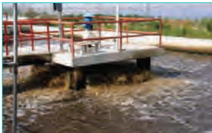
شکل ۵-۶- تصفیه‌خانه فاضلاب ارومیه
