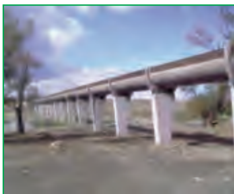
شکل ۱-۴۵- کانال انتقال آب (سیاه کمر)
