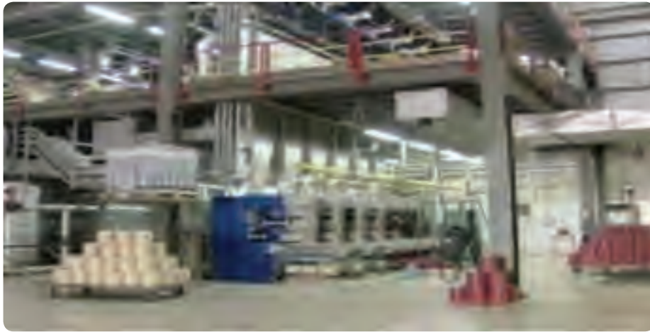
شکل ۱۵-۶- کارخانه کابل نوری یزد
